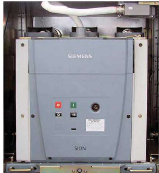
Отсек выкатного элемента с выключателем
