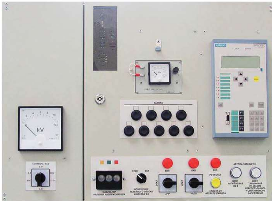
Лицевая панель отсека релейной защиты и автоматики
