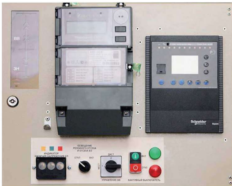
Лицевая панель отсека релейной защиты и автоматики
