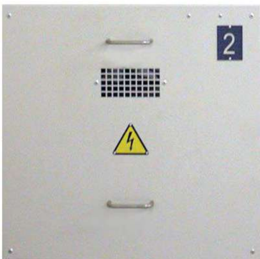
Дверь отсека кабельного присоединения
