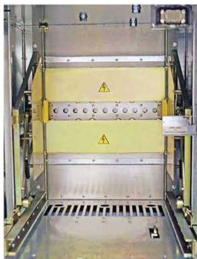
Отсек вакуумного выключателя без SION
